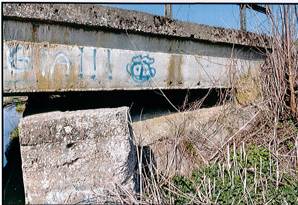
Fot. 5. Gzyms od spodu i podpora obiektu
