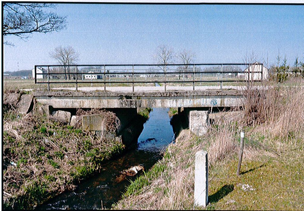
Fot. 7. Gzyms i podpora obiektu
